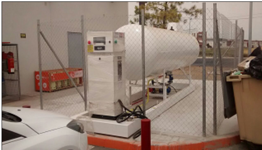
INSTALACIÓN SURTIDOR ADBLUE ES. REPSOL LA TANA Y HUENEJA
